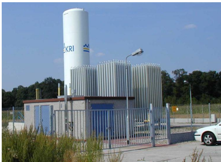
Joonis 18. LNG regasifitseerimise jaam Poolas, maht 60 m 3 . ( http://www.chartferox.com/systems/systems-lng-systems-white-paper.htm )
