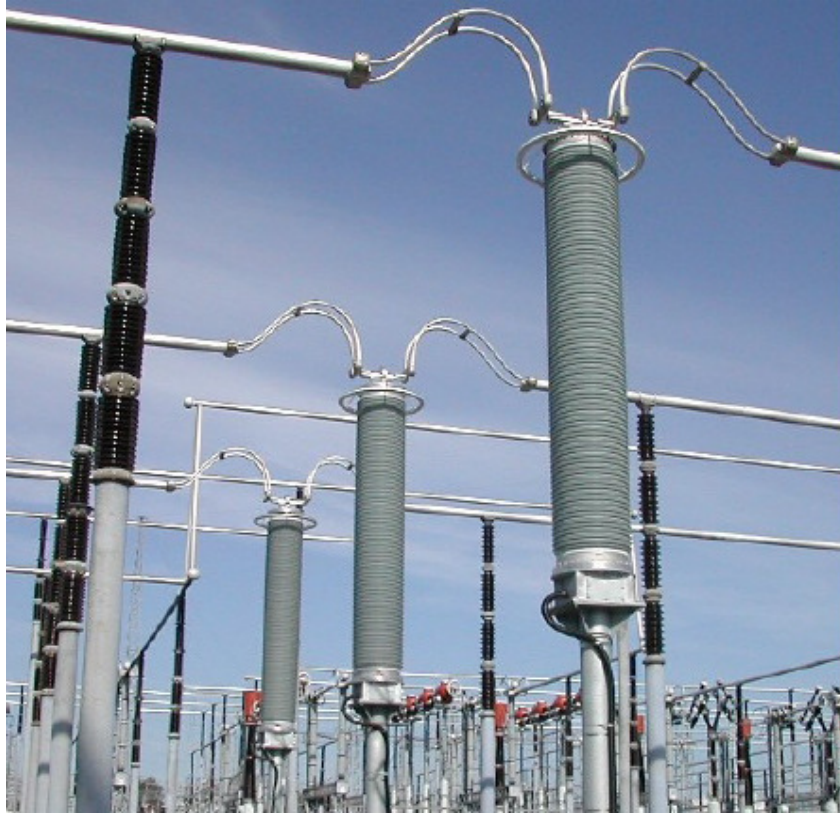
Joonis 4.6. NXVCT 550 kV paigaldises Kanadas, Vancouveri lähistel.
