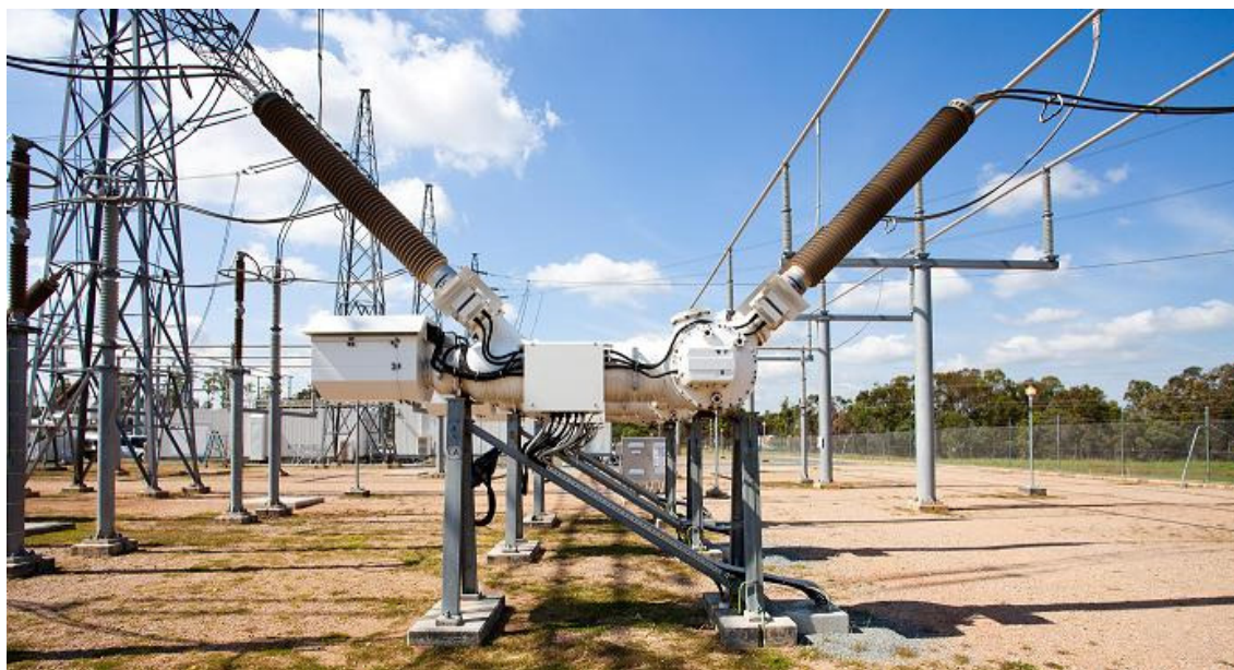
Joonis 4.15. ABB hübriidisolatsiooniga alajaamasektsioon Loganlea alajaamas. Näha on kaks kombineeritud ABB ELK-CP3 kombineeritud pinge- ning voolumõõtemuundurit. [52]
