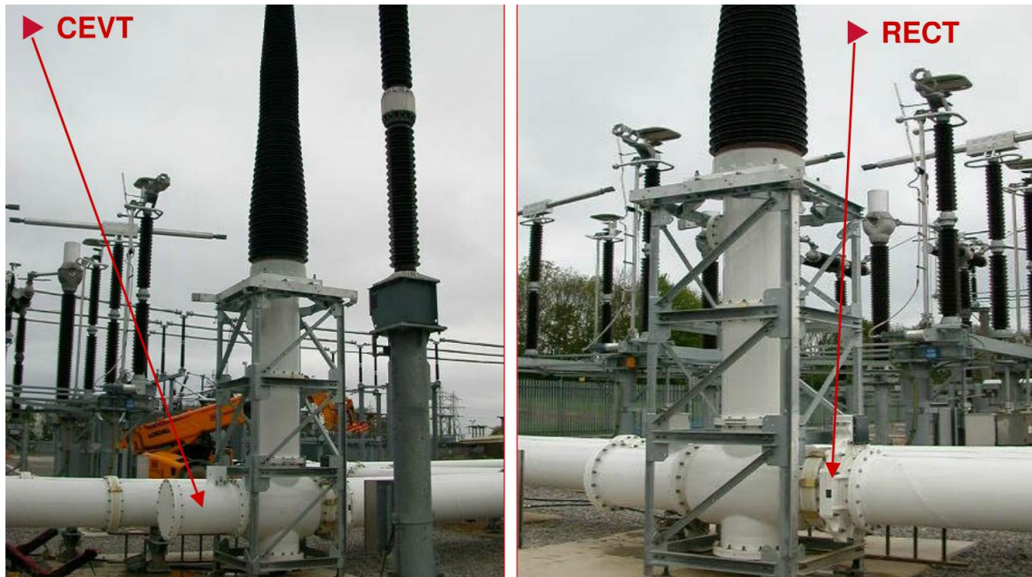
Joonis 4.8. Osbaldwick'i alajaama installeeritud katseadmed [44], Alstom COSI-CEVT ning COSI-RECT.
